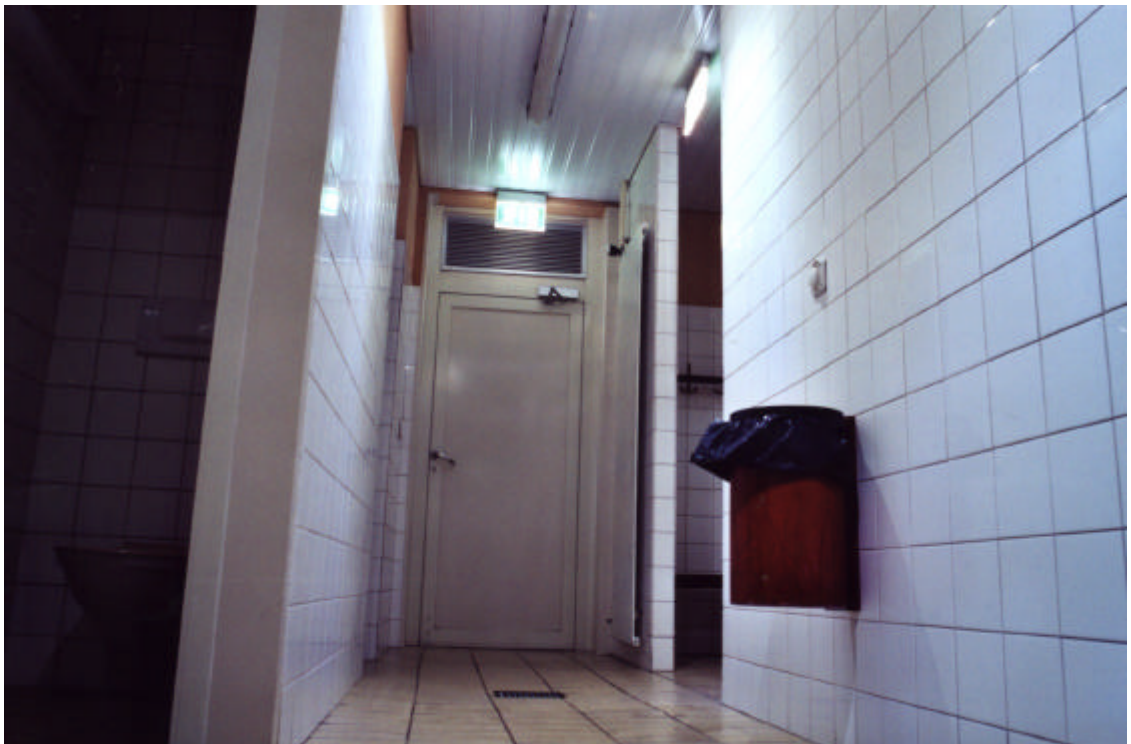
Vestiaires de la piscine de Vailly à BERNEX ( vide d'étage de 2,5m. )
